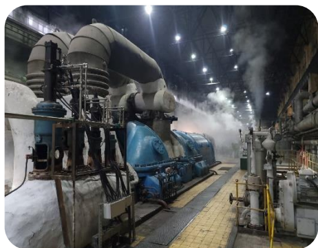
Богословский алюминиевый завод Комплекс циклонной печи кальцинации продукционного гидрата с узлом фильтрации ОПЦУ-1000
